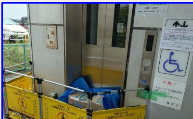
JR稲沢駅東口エレベーターが大雨で冠水し故障 休日・夜間工事で復旧！！感謝！！
